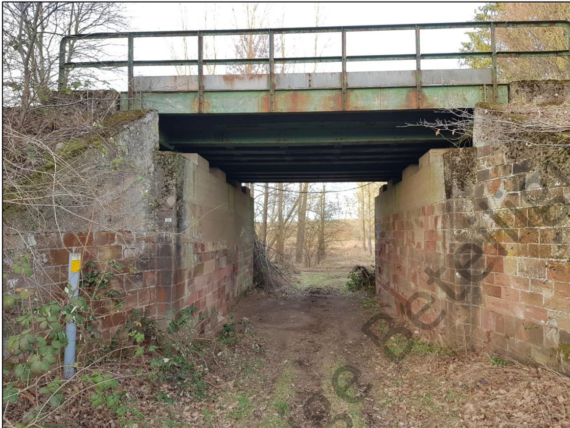
Abb. 36: Die Eisenbahnunterführung im Nordostteil des Untersuchungsraumes. Ein Beispiel für ein potenzielles Fledermausquartier aus Menschenhand.
